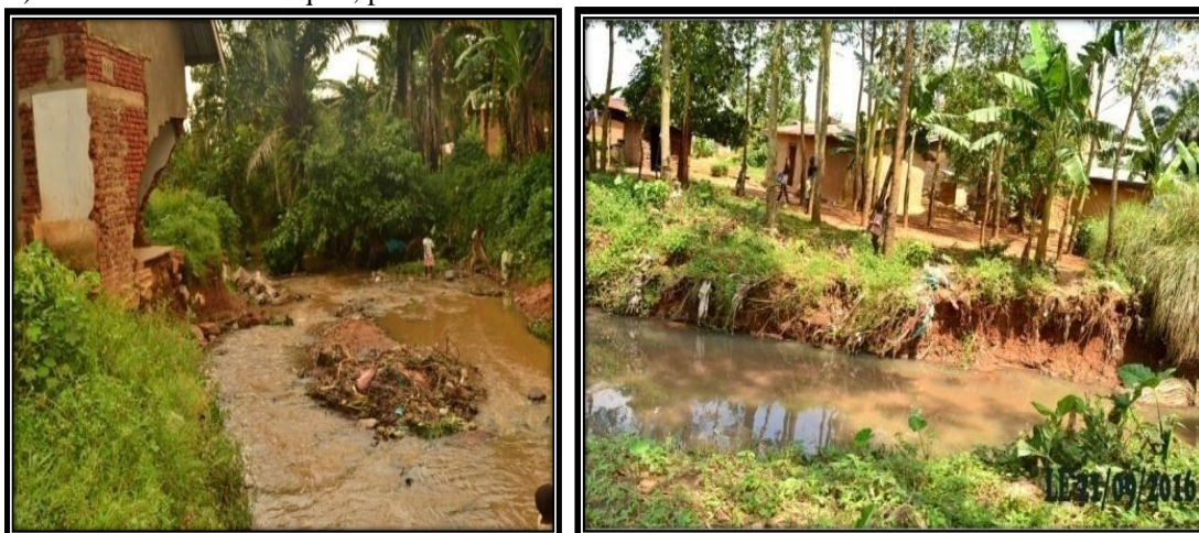
Photo III. et IV Constructions anarchiques le long de la rivière Biautu
